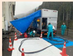
電源車で避難所への電力供給
