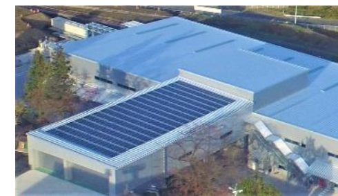
新治工場のソーラーパネル
